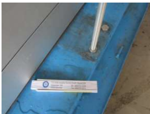
Bild 6.3-3: Wasseraustritt bei der Sohlendichtung neben der „Mittelstütze“
