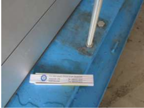
Bild 6.3-5: Wasseraustritt bei der Sohlendichtung neben der „Mittelstütze“
