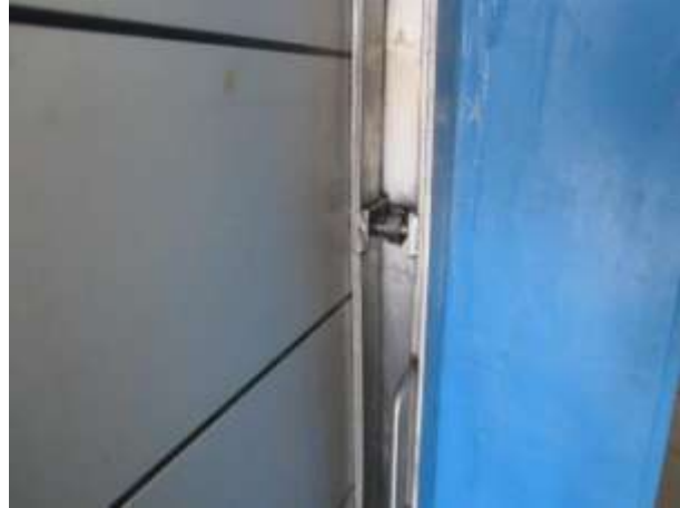
Bild 6.3-6: Wasseraustritt an den seitlichen Befestigungen
