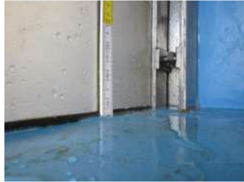
Bild 6.3-2: Wasseraustritt in den Ecken der Sohlendichtung
