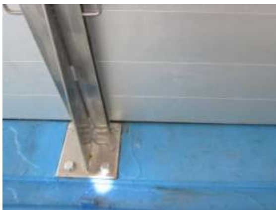
Bild 6.3-3: Wasseraustritt bei der Sohlendichtung neben der Mittelstütze
