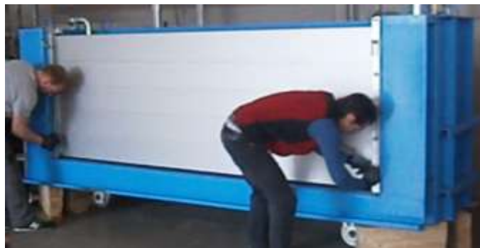
Prüfbox nach dem Einbau des Hochwasserschutzsystems
