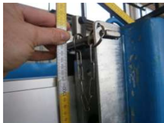
Bild 6.2-6: Fixierung der Dammbalken mittels Vertikalspanner
