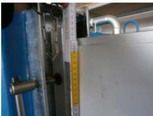
Bild 6.2-5: Fixierung der Dammbalken mittels Vertikalspanner
