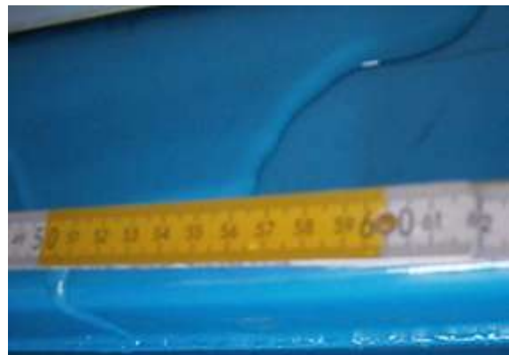
Bild 6.3-2: Wasseraustritt in der linken Ecke der Sohlendichtung (ca. 60 cm)
