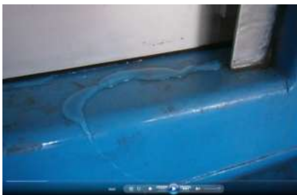
Bild 6.3-3: Wasseraustritt in der rechten Ecke der Sohlendichtung
